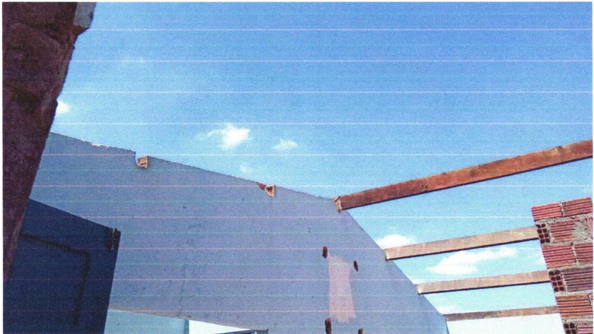
Foto 13 - Retelhamento em cobertura com telha ceramica tipo canal comum, Itabaiana ou similar.
